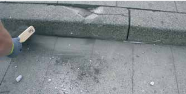
Ausbrüche in Randsteinen...
