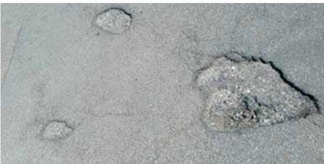
Ausbrüche in Fahrbahn...
