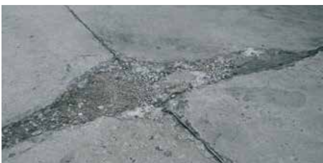
Ausbrüche in Beton...
